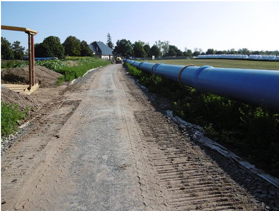
Transcurso rectilíneo de la tubería provisional a lo largo de la pista que llega a la central de Canitz
