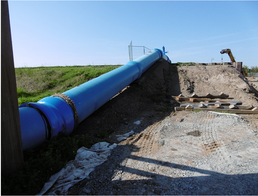
Verlauf der Interimsleitung DN 800 über den Deich zwischen Rohrbrücke über den Fluss Mulde und dem Wasserwerk Canitz
