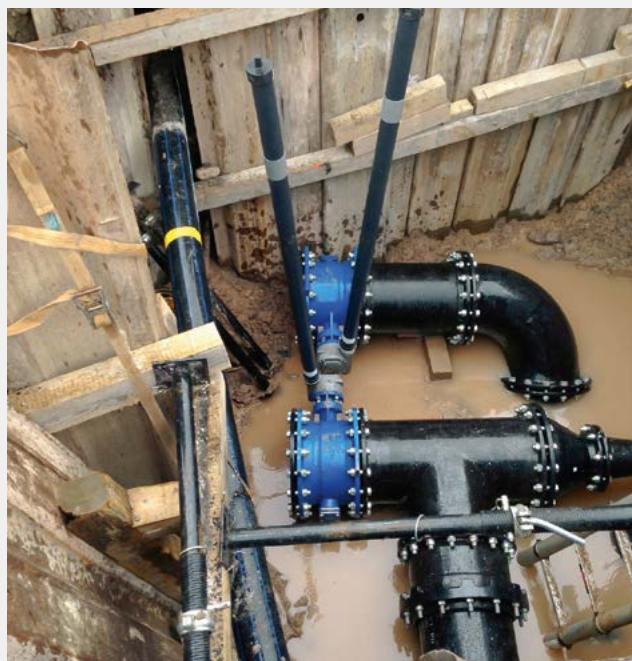
Fig. 6 Abgänge und vonRoll -Absperrklappen DN 400. Sorties et clapets de vanne DN 400 vonRoll .
