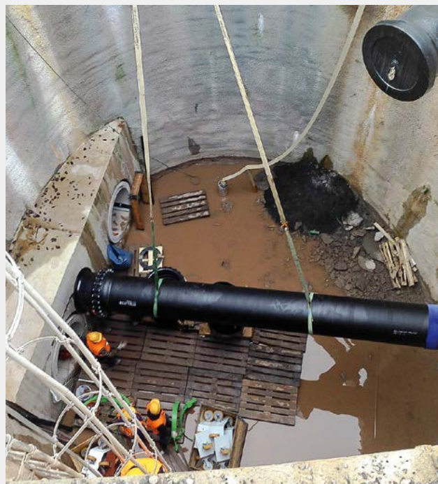
Fig. 7 Doppelleitung DN 700 im Schacht (Microtunnel aus Beton). Conduite double DN 700 dans le puits (microtunnel en béton).
