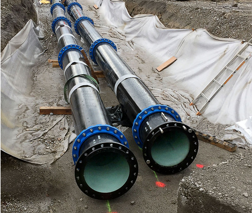
ARA Werdhölzli DN 600 double pipeline PFA 25 bar
