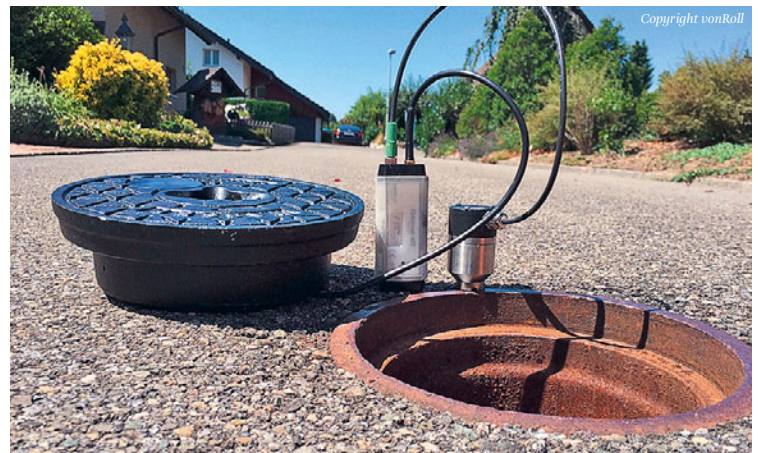
Ein optimiertes Druckmanagement bedeutet, dass der durchschnittliche Druck im Netz bei der digitalen Wasserversorgung deutlich niedriger ist. Hierdurch entstehen auch weniger Lecks.
